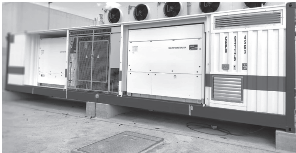
FIGURA 4 PROYECTO H2 VERDE TMB. ELECTROLIZADOR Y MÓDULO DE POTENCIA
